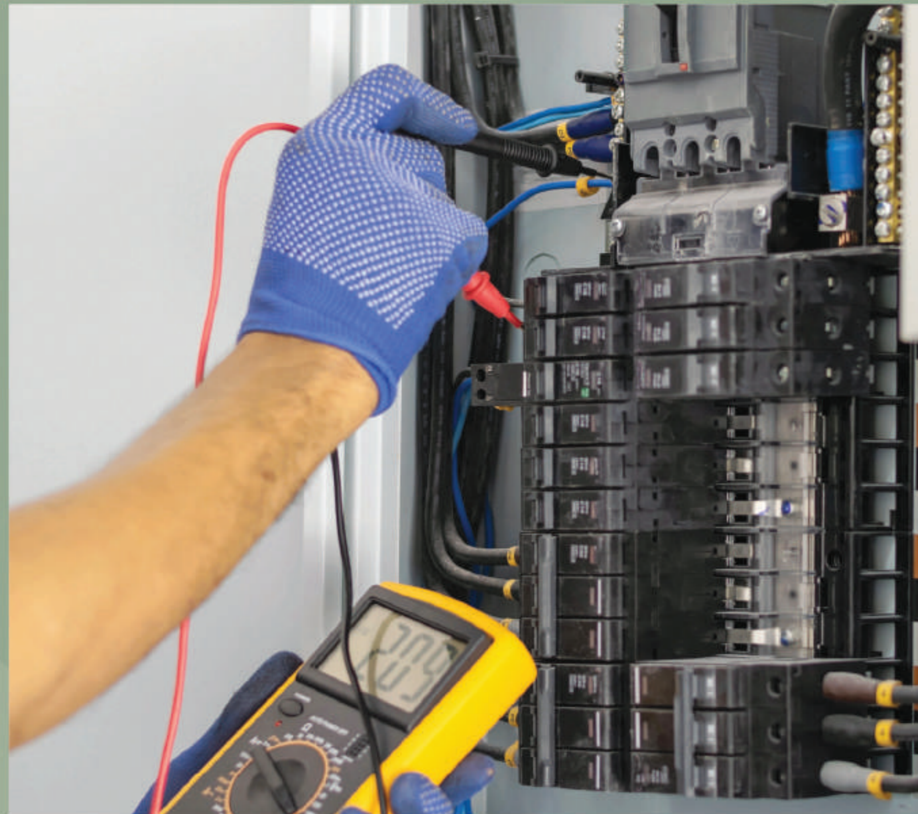
การตรวจสอบแรงดันไฟ เพื่อให้ได้มาตรฐาน
